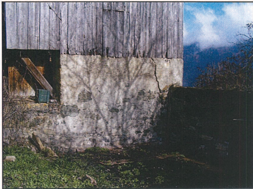
Figure 3: Hameau des MONTÉES – Lézarde d'une bâtisse ancienne.
