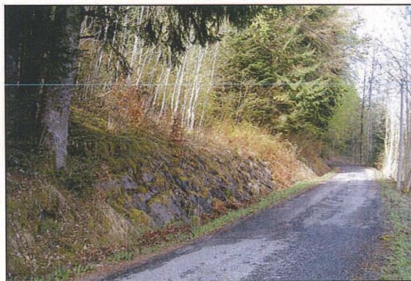
Figure 7: Glissement survenu en février 1990 en amont de la voie communale surplombant CHEZ FILLOU.
